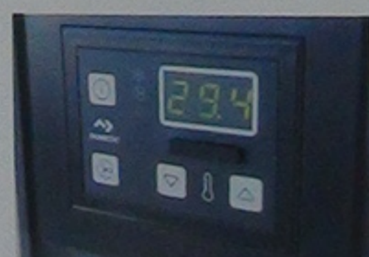
エアコンパネル (工場OP)
