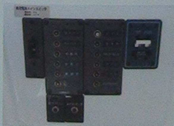
ブレーカーパネル
