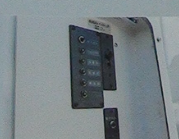
ブレーカーパネル
