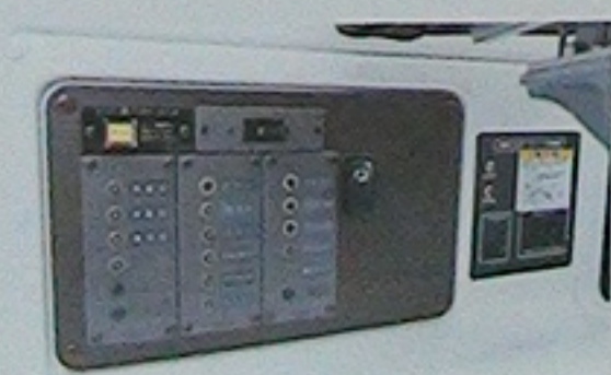
ブレーカーパネル
